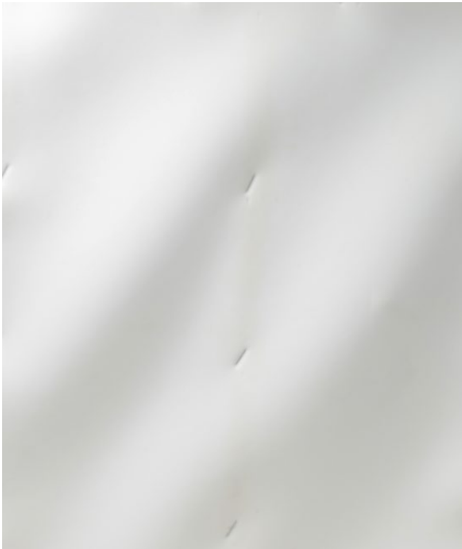
Bild 53: Schubbeulen der Gipsplatte
