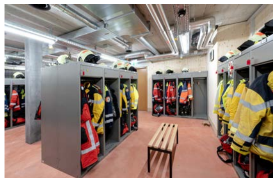
Die Materialien sind getrennt und die Haustechnik ist sichtbar montiert – so sind die Leitungen jederzeit zugänglich.
