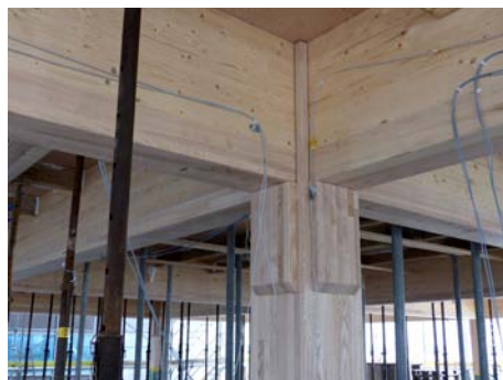
Der Holzskelettbau des „House of Natural Resources“ auf dem Gelände der ETH in Zürich besteht aus Fichten-BS-Holz-Trägern mit lokaler Laubholzverstärkung aus Esche auf der Unterseite, die Stützen sind komplett aus Eschenholz. Die Träger werden über Vorspannkabel stumpf gegen die durchgehenden Stützen verspannt. Laubholz wurde da eingesetzt, wo höhere mechanische Belastungen auftreten
