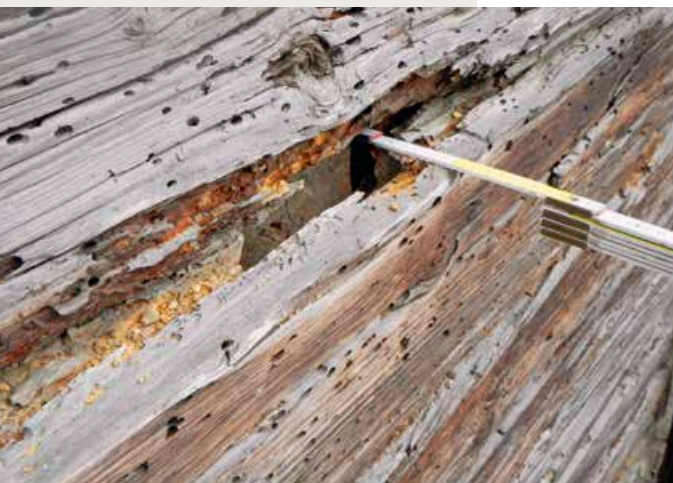
▼ Geschädigter Blockbalken, entdeckt bei der Bestandaufnahme vor der zweiten Sanierung
