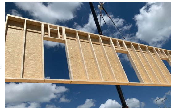
Dank der Holzbaumontage schreiten die Arbeiten zügig voran und sind im Zeitplan.
