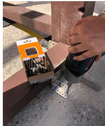
HECO_Referenz_Boulderwand_München_8 Für die Verankerung der Holzkonstruktion im Boden verwendeten die engagierten Helfer den Schraubanker MULTI-MONTI-plus in Edelstahl. (Bild: HECO-Schrauben)
