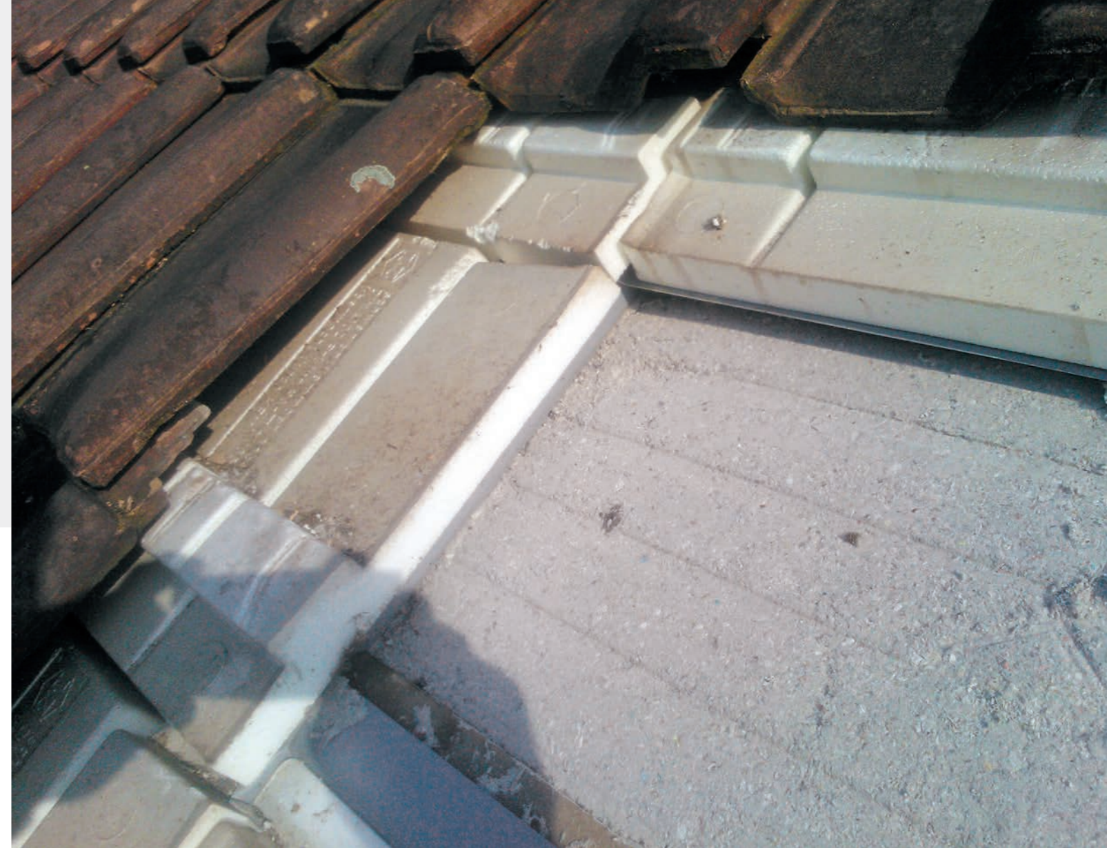
Einsicht in geöffnetes Steildach mit obenliegender bestehender Dämmung. Sehr gut sichtbar die lückenlose Dämmschicht des isofloc Zellulosedämmstoffs.
