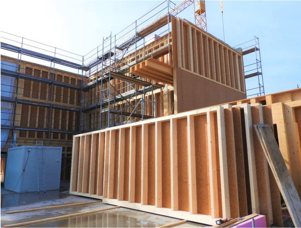
Die von Pfleiderer gestifteten LivingBoard face Platten bei der Montage während des Baus der Kletterhalle.
