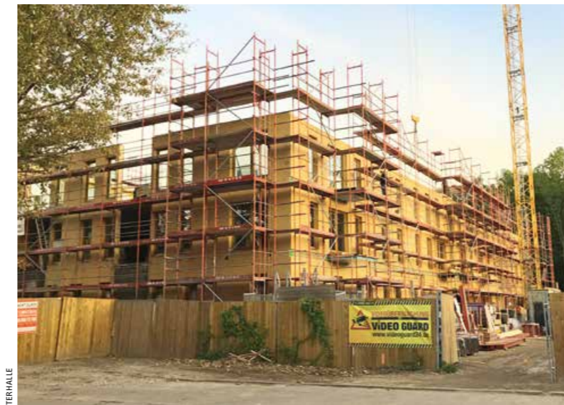
◀ Die schlagregenfeste Hülle ist fertig. Nur die Putzfassade wird erst später hergestellt
