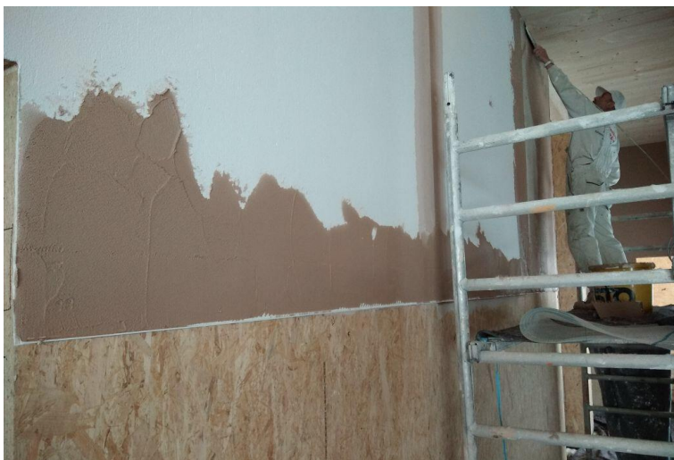
Auf den weißen Haft- und Sperrgrund wird der erdfarbene Rotkalk Grundputz aufgetragen (Foto: SWISS KRONO | Hermann Veldung)
