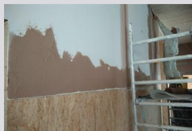
Auf den weißen Haft- und Sperrgrund wird der erdfarbene Rotkalk Grundputz aufgetragen
