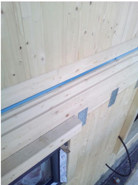
Abbildung 1: eingebautes Lager (blau)
