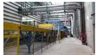
Bild 2: Dank optimierter Produktionsprozesse und Materialnutzung punktet die neue Anlage auch unter ökologischen Aspekten.
