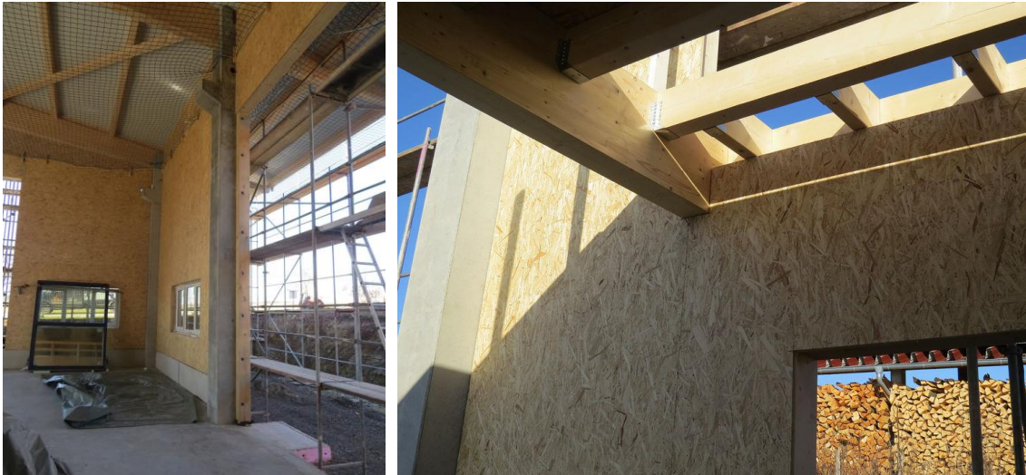
Wandhohe Holzrahmenelemente zwischen den Stahlbeton-Achsstützen aus SWISS KRONO OSB bright (Copyright: Holzbau Benjamin Roller | Fotos: SWISS KRONO GmbH)
