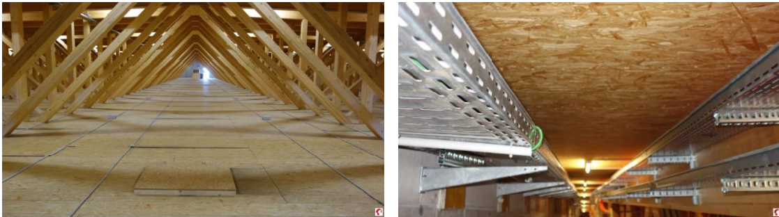
Raum und Flächen für Installationen über dem Untergurt der Fachwerkträger (links) und Installationschächte an der Unterseite der Dachelemente, entlang der Obergurte an den Fachwerkträgern (Bildnachweis: Messe Dornbirn GmbH)
